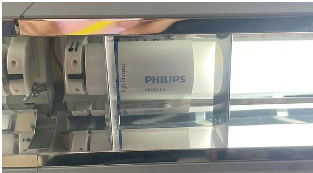
ภาพที่ 5 หลอดไฟ LED ภายในหอสมุดวังท่าพระ
