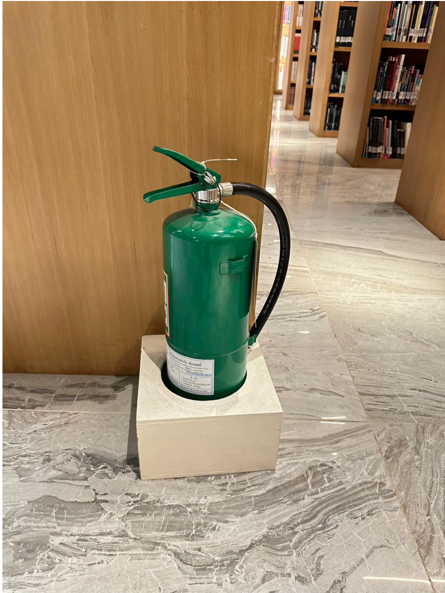
การติดตั้งถังดับเพลิงภายในอาคารสำนักงาน ฝ่ายหอสมุดวังท่าพระ บริเวณชั้น 1
