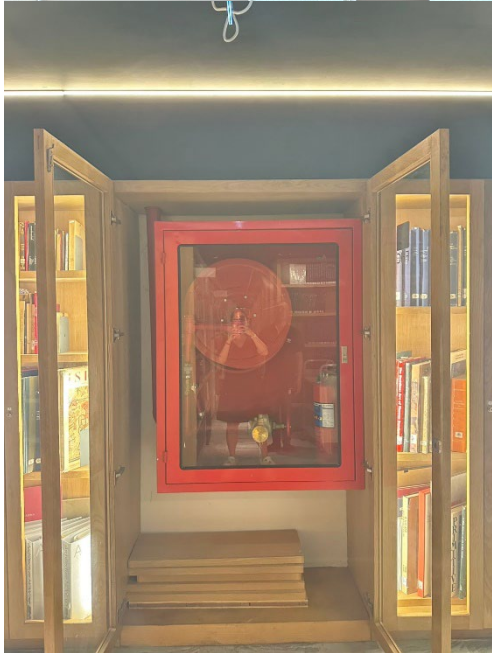
ภาพตัวอย่างการติดตั้งสัญญาณแจ้งเหตุเพลิงไหม้ ตัวดักจับควัน (Smoke Detector) และสายฉีดน้ำดับเพลิงและตู้เก็บสายฉีด ของฝ่ายหอสมุดวังท่าพระ สำนักหอสมุดกลาง มหาวิทยาลัยศิลปากร
