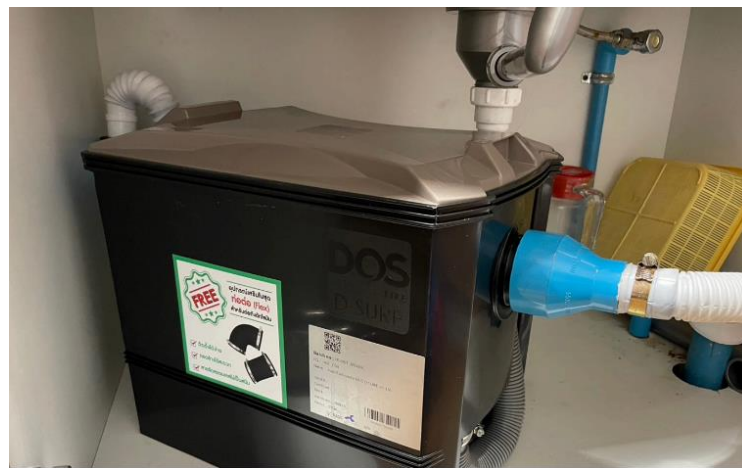
ภาพที่ 2 บ่อดักไขมันที่ติดตั้ง ณ จุดปล่อยน้ำเสีย
