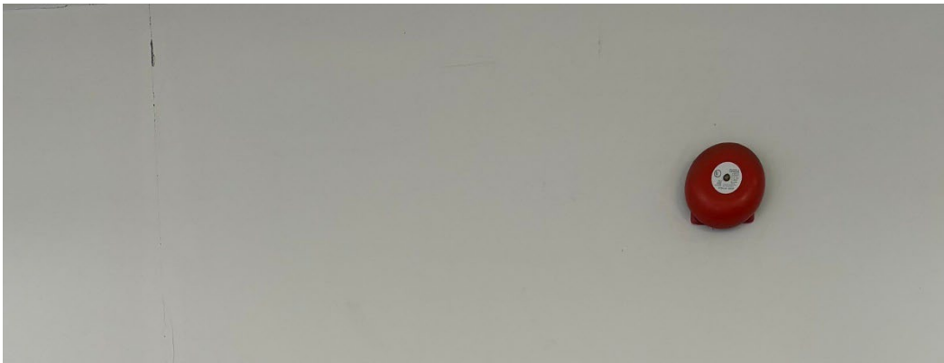
ตัวอย่างภาพกริ่งสัญญาณแจ้งเหตุฉุกเฉิน (เตือนเหตุเพลิงไหม้)
