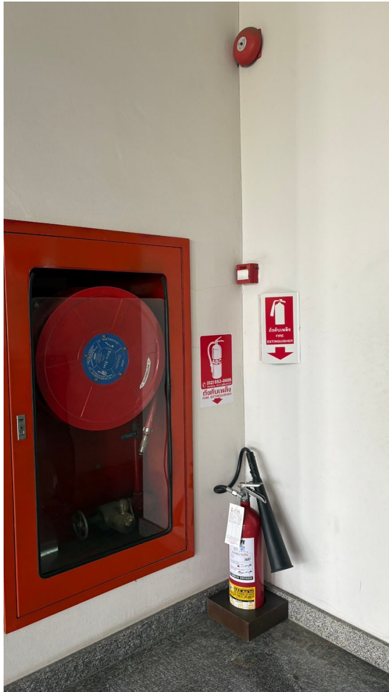
การติดตั้งถังดับเพลิงภายในอาคารหม่อมหลวงปิ่น มาลากุล ชั้น 5 บริเวณทางเข้าห้องน้ำชาย-หญิง
